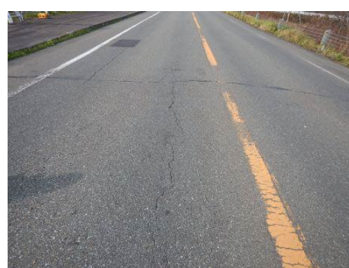
(b) 上部道路縦断方向も含む亀裂
