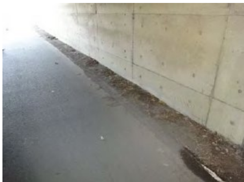
(b) 排水溝の土砂詰まり
