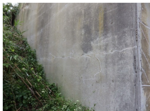
(b) 乾燥収縮によるひびわれ 写真-3 ウイングのひびわれの例
