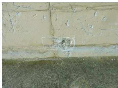
写真-4 コンクリート欠損の例
