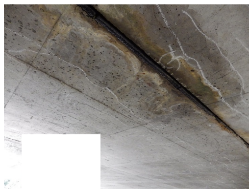
(c) 炭酸カルシウムが浮き出た例
