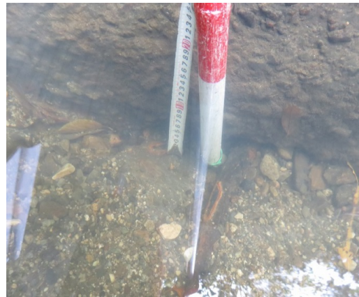
写真-8 底板直下の洗掘による空洞
