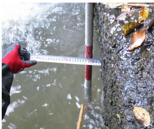
写真-10 底版直下の洗掘の例
