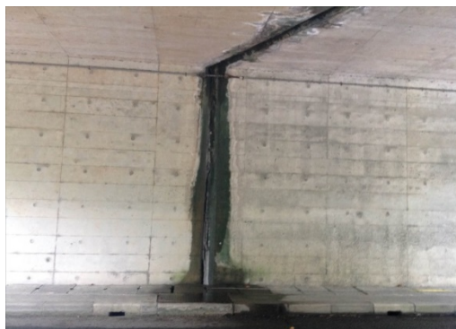
(a) 継手部材の劣化と漏水
