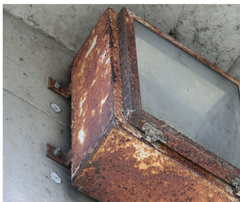
写真-3 照明器具の腐食の例
