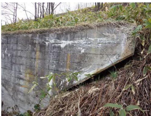
(c) 盛土とウイングの隙間
