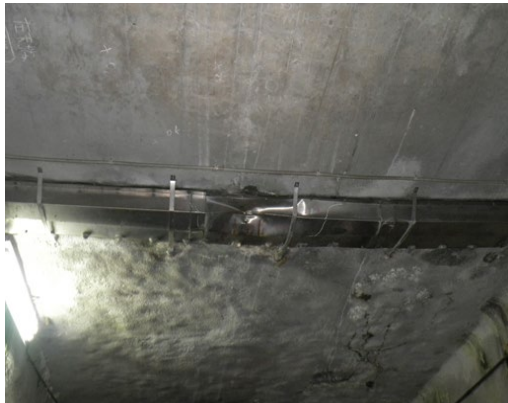
(a) 導水工の破損による漏水
