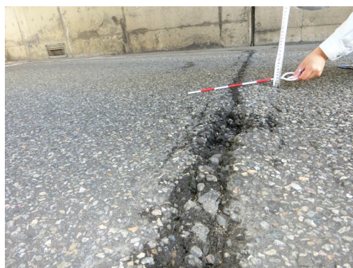
(a) 継手位置に沿った亀裂・段差
