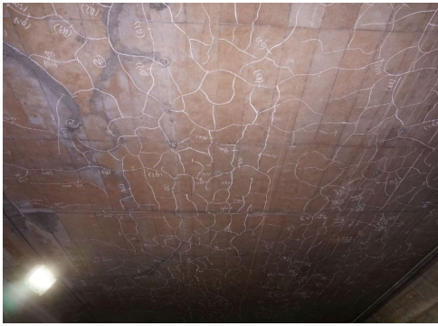
写真-1 亀甲状のひびわれの例
