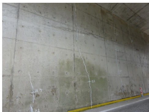
写真-2 側壁の鉛直方向ひびわれの例
