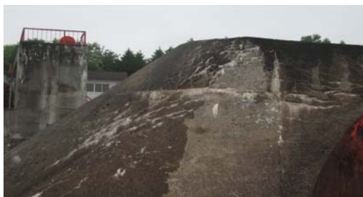
写真-1 堰柱部の凍害ひびわれ
