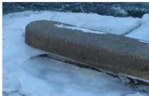
写真-2 きつ水部の凍結状況
