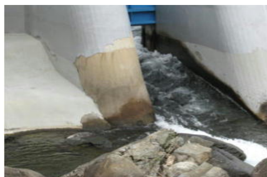
写真-3 表面補修施工後の堰柱部の劣化状況
