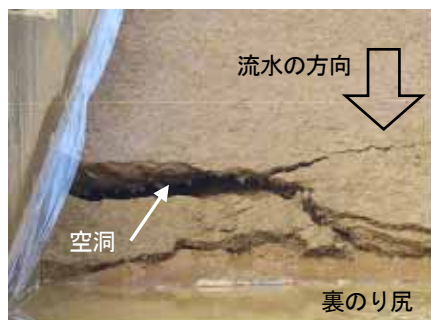
写真－2 堤防裏のり面被覆下の空洞
