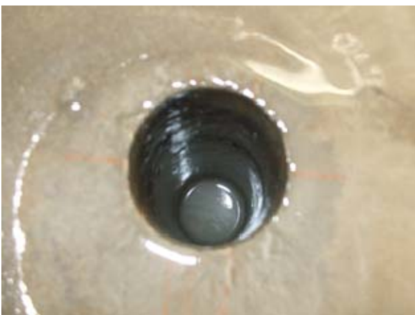
写真-3 コア抜き後
