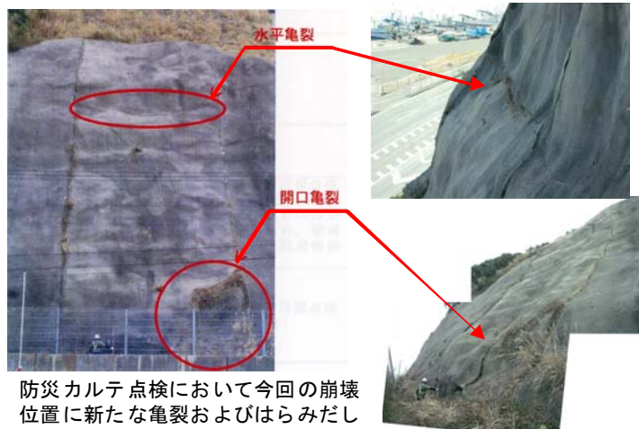
図－２ 岩盤崩壊の災害事例
