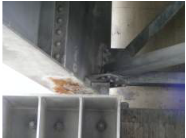
写真 - 10 桁端部の劣化状況
