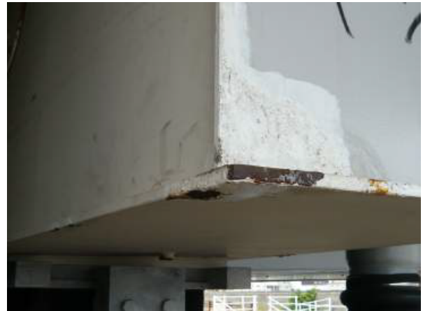
写真-2 桁端部の劣化事例
