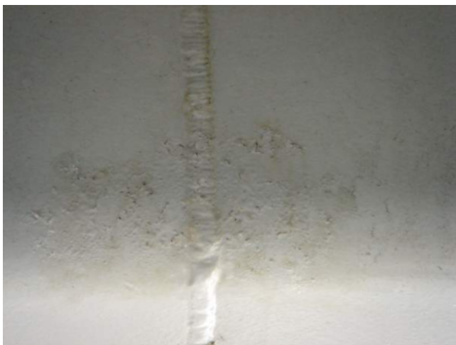
写真-3 溶接ビード周辺の劣化事例
