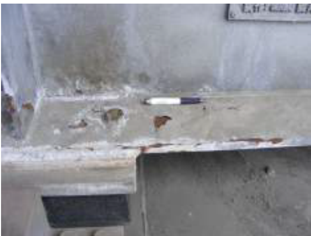
写真 - 7 下フランジの劣化状況
