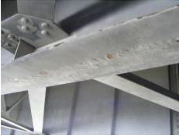
写真 - 9 下フランジ下面の溶射皮膜の劣化状況
