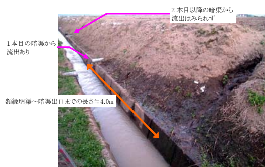
写真-1 輪換畑の排水路法面における浸潤線 (平成16年5月12日、文献 2) より引用)
