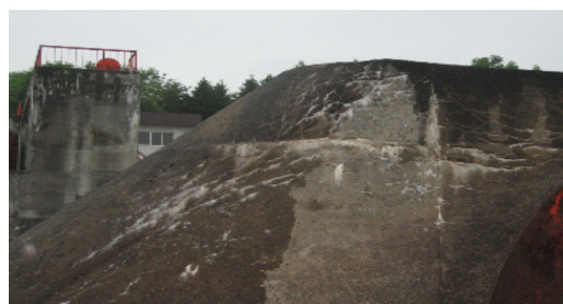
写真-1 堰柱部の凍害ひびわれ
