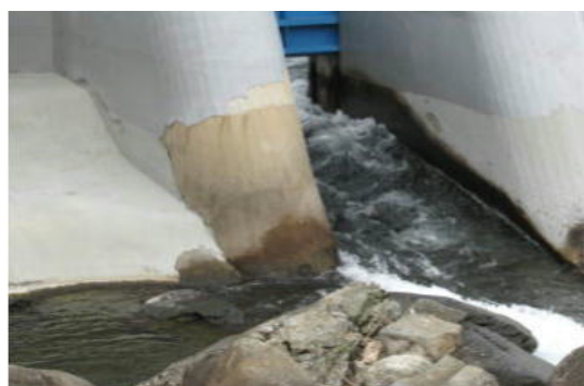
写真-2 表面補修施工後の堰柱部の劣化状況
