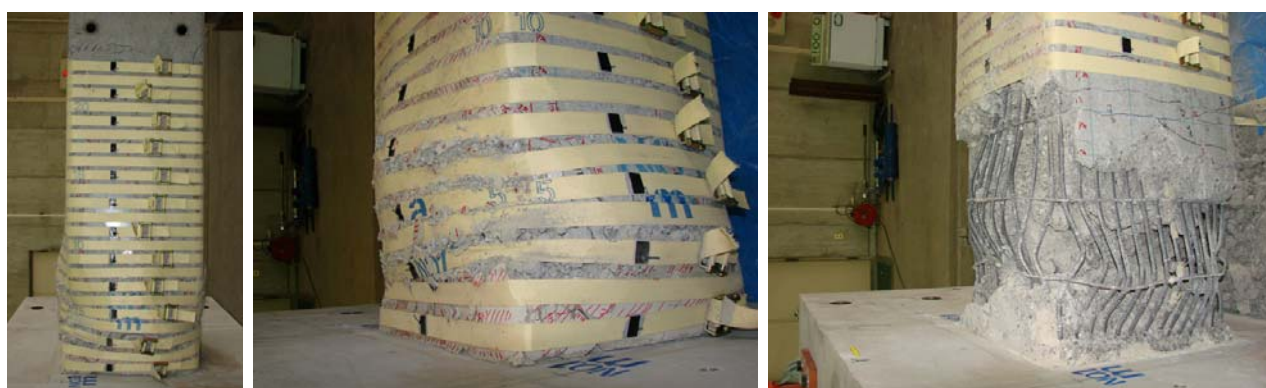
(a) 柱全体の損傷
