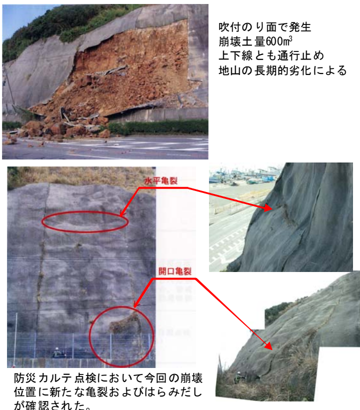
図－12 岩盤崩壊の災害事例
