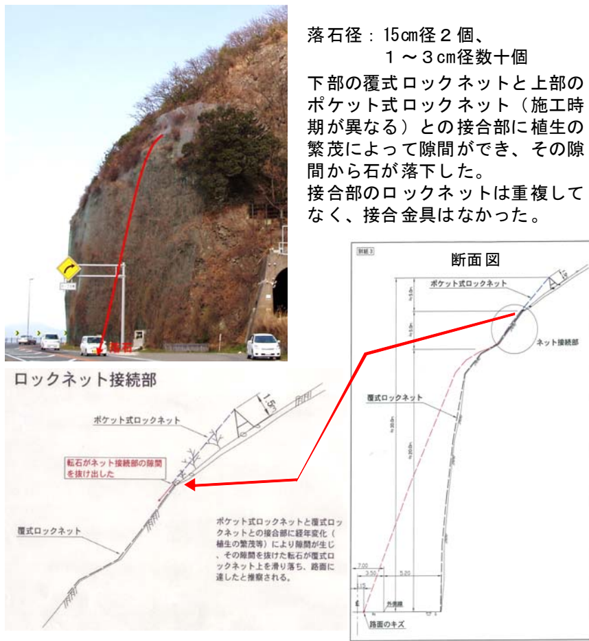
図－11 落石の災害事例
