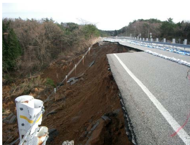
写真 1.1 能登有料道路の盛土崩壊
