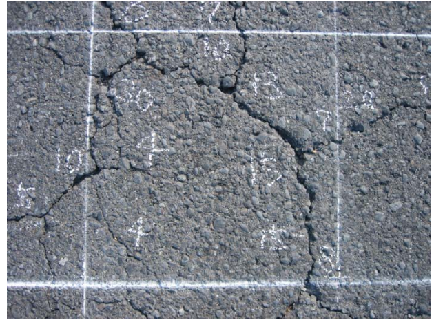
写真-1 ひび割れの幅の記録
