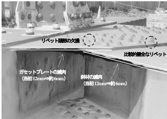
図-6 ガセット部の腐食状況
