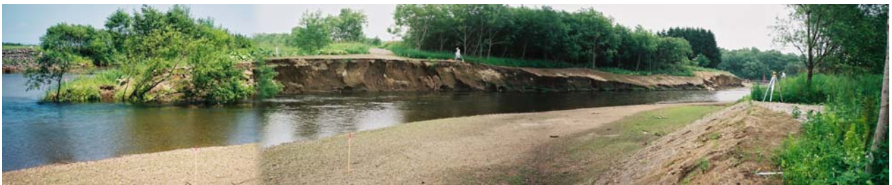
図 - 15.1.8 分岐部：蛇行河道左岸側の河岸浸食状況（平成 14 年 7 月：大規模洪水前）
