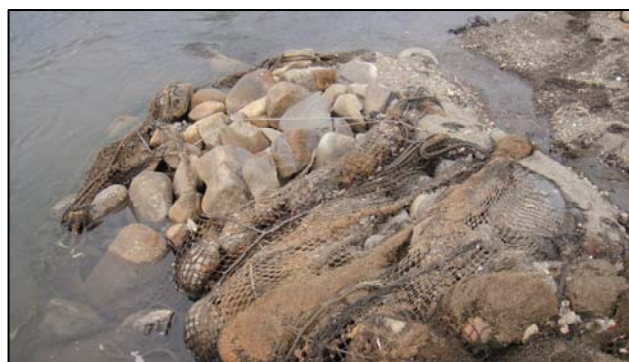
図 - 15.1.35 分流堰の構造が一部破損
