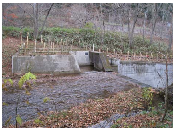
写真-2 魚道上流部の状況(擁壁が水制工として機能し土砂堆積が抑制されている様子)
