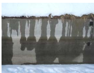
写真-5 南面における冬期間の水路側壁 (セメント系補修区間)
