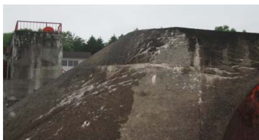
写真-1 堰柱部の凍害ひび割れ
