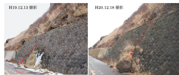
写真-6 変状の進行例(雷電 7-7, 7-8)
