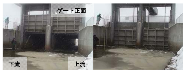
閉操作前(13:46) 閉操作後(13:47) 写真-13 釧路A樋門：引上げ式ローラーゲート(H21. 2. 20)
