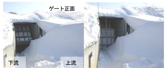
閉操作前(13:44) 閉操作後(13:48) 写真-11 十勝A樋門： 門柱レス油圧引上げ式ゲート
