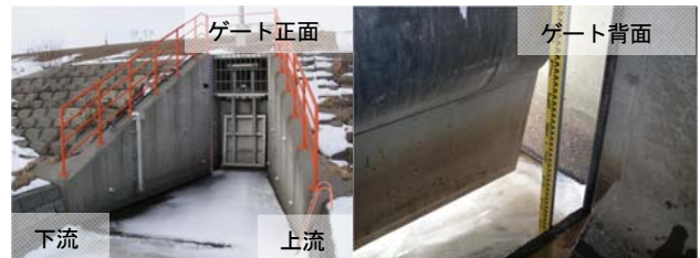
写真-5 鶴川 C 樋門：自動開閉ゲート (H21. 2. 27)
