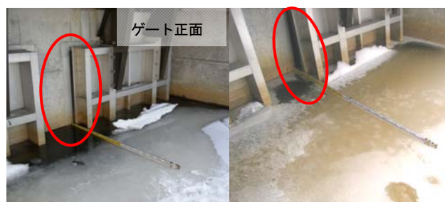
H21. 2. 9 H21. 2. 20 写真-14 釧路B樋門：自動開閉ゲート ※水位に応じてゲートが開閉している状況
