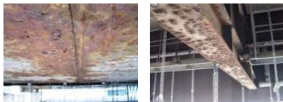
a) 箱桁下面 b) 横桁 写真-5 素地調整前の異常腐食の状況 (A橋梁)
