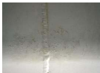
b) 溶接部周囲 c) ステンレスボルト周辺 写真-13 金属溶射(AL) + 塗装後13年 (H橋梁)
