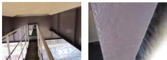
a) 桁内面 b) 横桁下面 写真-6 塗装で補修後4年の状況 (A橋梁)
