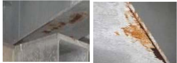
d) 狭隘部の施工不良
