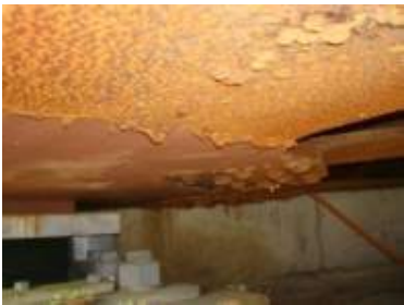
写真－4 部分塗装の塗膜のはく離
