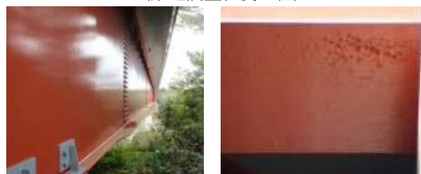
a) 外桁外面 b) 下フランジ下面孔食跡 写真-9 塗装で補修後3年 (D橋梁)
