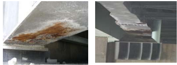
c) 狭隘部の施工不良による腐食
