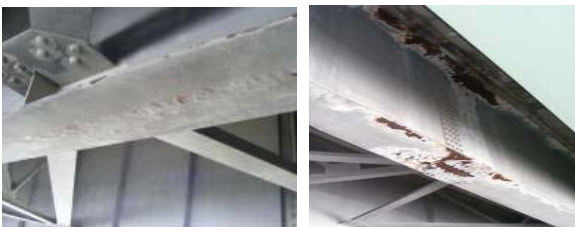
a 溶射皮膜の浮き
