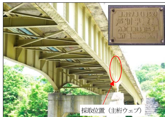
写真-1 経年鋼材(旭橋:北海道芦別市)
