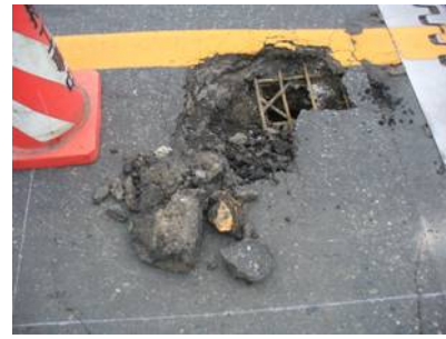
写真-2 陥没が生じたRC床版
