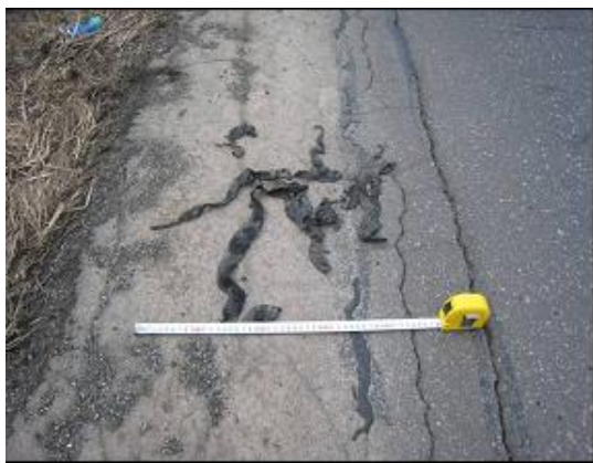
写真-1 シール材が剥がれた状況
