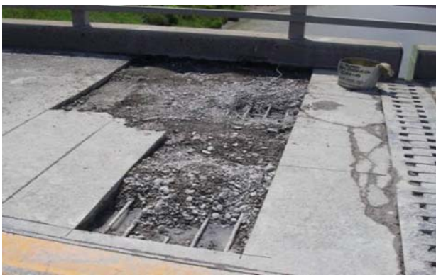
写真-4 凍害損傷（砂利化）状況
