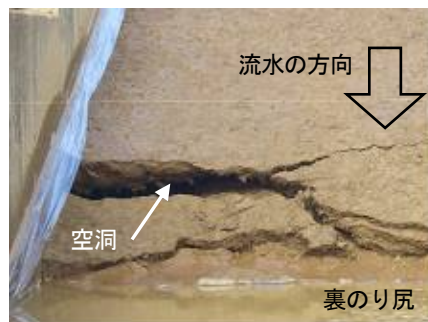
写真-5 堤防裏のり面の被覆工下の空洞
