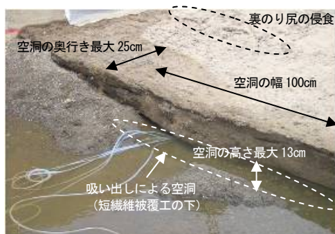
吸い出しによる空洞の状況
