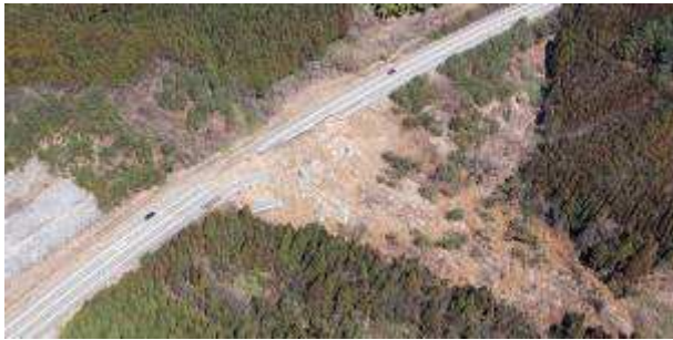
写真 2.1 能登有料道路の崩壊状況 2)
