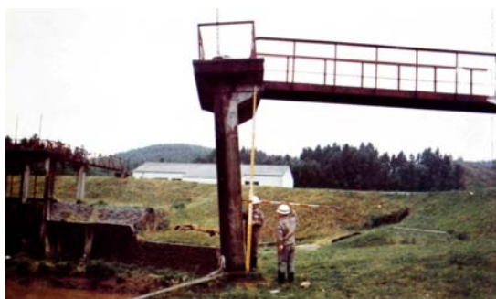
写真-1 阿久戸排水樋管の被災状況 28)
