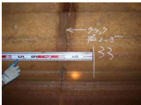
図-45 函体に生じたクラックの一例 (スパン3)
