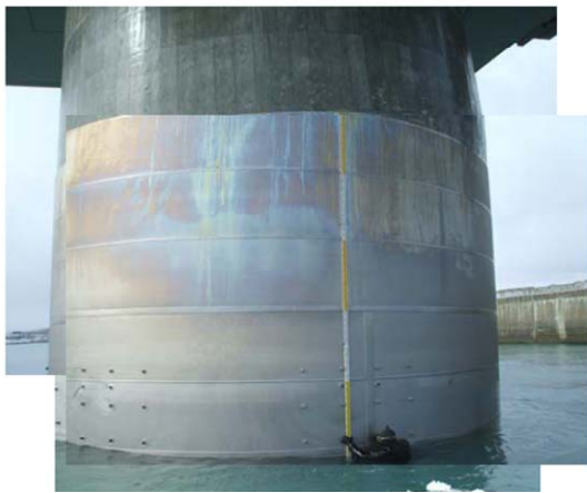
図-6.14 チタンクラッド鋼の外観
