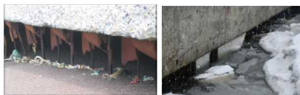
図-1.3 オホーツク海に面した鋼矢板の流氷による劣化例
