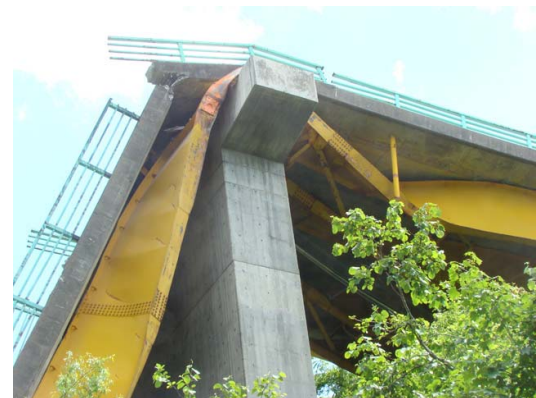
図-10 落橋した橋の被害状況 (上：全体、下：P2橋脚)
