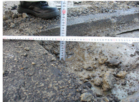
(b) 防水層下の床版コンクリートの脆弱化
