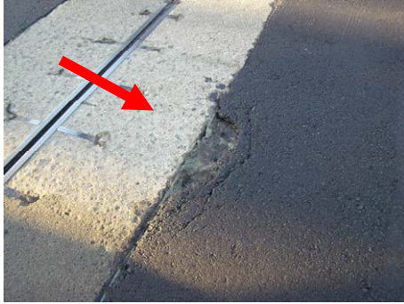
(a) 伸縮装置近傍での床版防水層のまくれ
