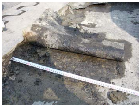
図-6 防水層の損傷状況③
