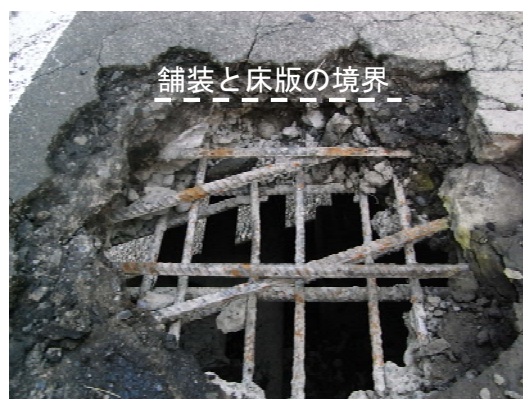
図-1 床版の陥没の例
