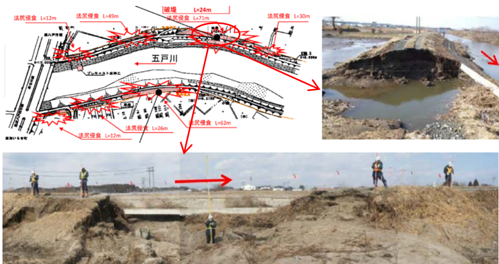
写真.3 五戸川（1.5k 左岸堤防破堤 写真は参考文献4）より引用
