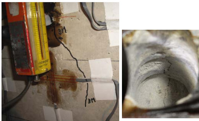
写真-6 ドリル削孔付近のひび割れ
