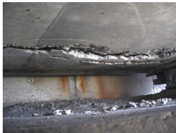
写真-1 PC 箱桁橋、桁端部の塩害事例(桁端部下面)
