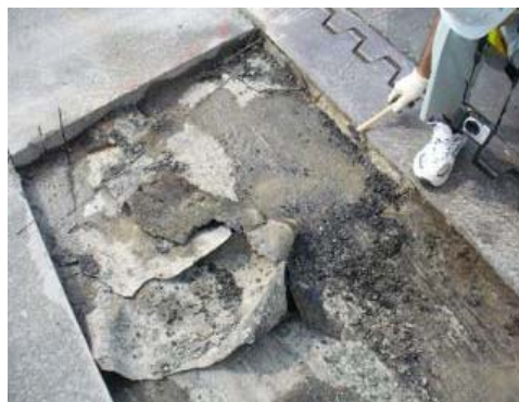
図-13 伸縮装置近傍での防水層の損傷例
