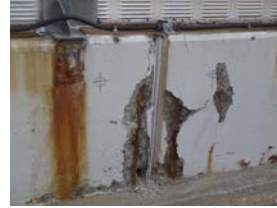
図-3 目地部の劣化状況例 (平成24年度)
