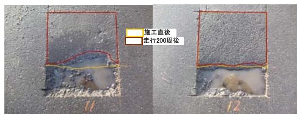
図-27 常温混合物の残存状況（走行200 周後）
