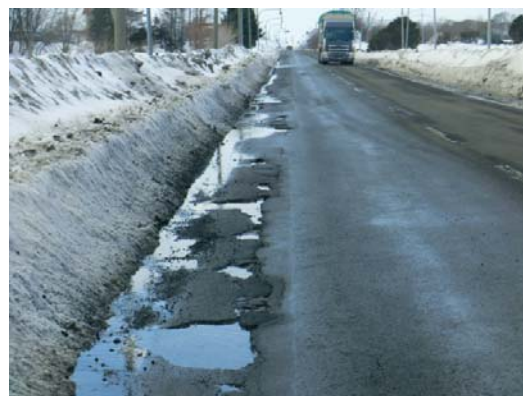
図-13 路肩の堆雪からの融雪水が影響したポットホール
