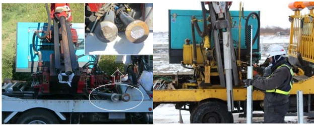
写真6 折損した打ち込み治具と改良した打ち込み治具
