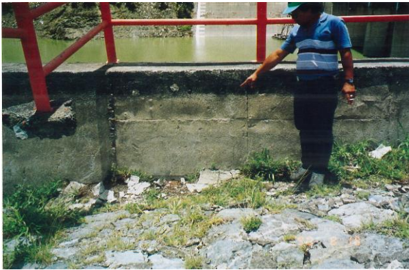
図-5.3 Ambuklao ダムにおける非常用洪水吐導流壁に隣接する堤体の沈下の状況 3)
