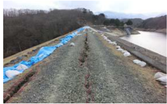
図-4.1 アースダム天端に発生した亀裂の例
