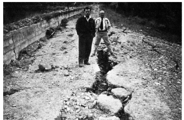
図-5.6 Hebgen ダムの露出したコンクリートコア（左側）と天端に発生した亀裂（中央） 5)
