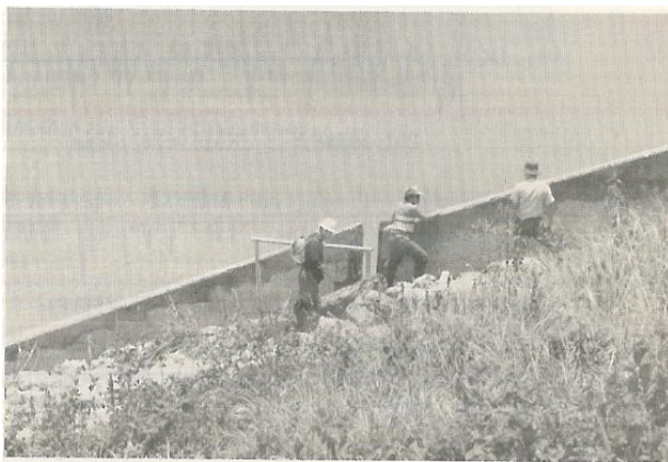
図-5.4 Ambuklao ダムにおける非常用洪水吐導流壁のジョイントの開口の状況 3)
