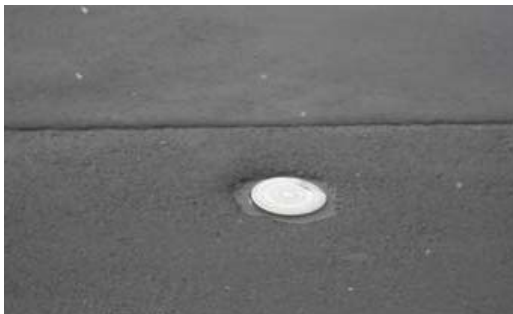
写真－3 路面センサーの設置状況②
