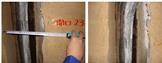
図-4.3 管内点検で確認された継手の開きと止水板の破損(東北地方整備局提供)
