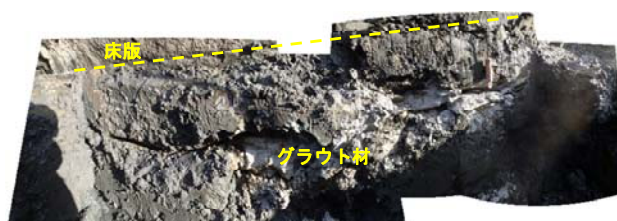
図-4.9 床版下で確認されたグラウト材
