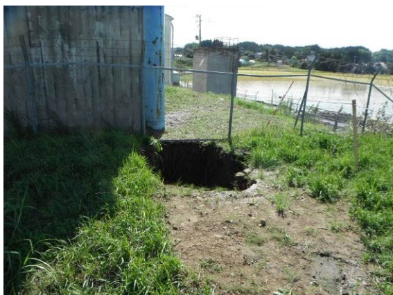
図-4.6 吐出水槽脇の陥没孔 (東北地方整備局提供)
