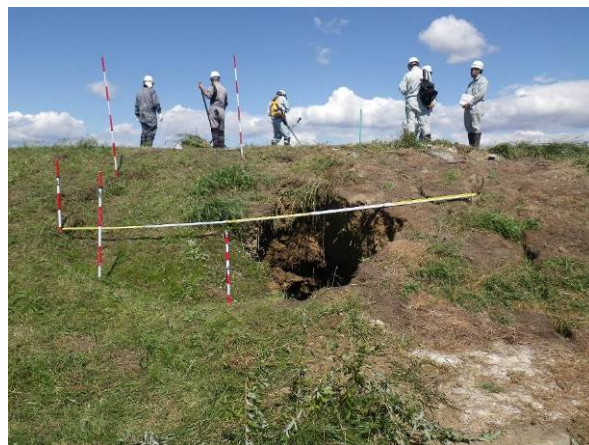
図-4.7 堤内側のり肩の陥没孔（東北地方整備局提供）
