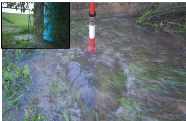
図-4.5 吐出水槽脇からの漏水の様子 (東北地方整備局提供)
