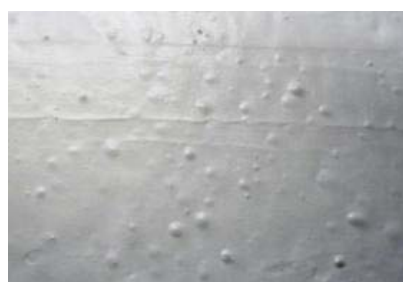
写真-5.2 湿潤状態での塗布で生じたふくれ
