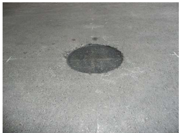
写真-2 6,983万回载荷後の路面状況
