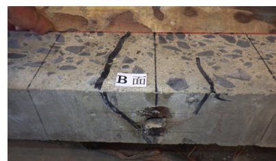
写真-8 ドリル孔付近のひび割れ調査 上：上縁から 113mm での断面(切断面) 下：上写真の矢印方向斜め上から撮影
