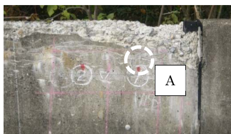
図-39 凍害劣化の状況
