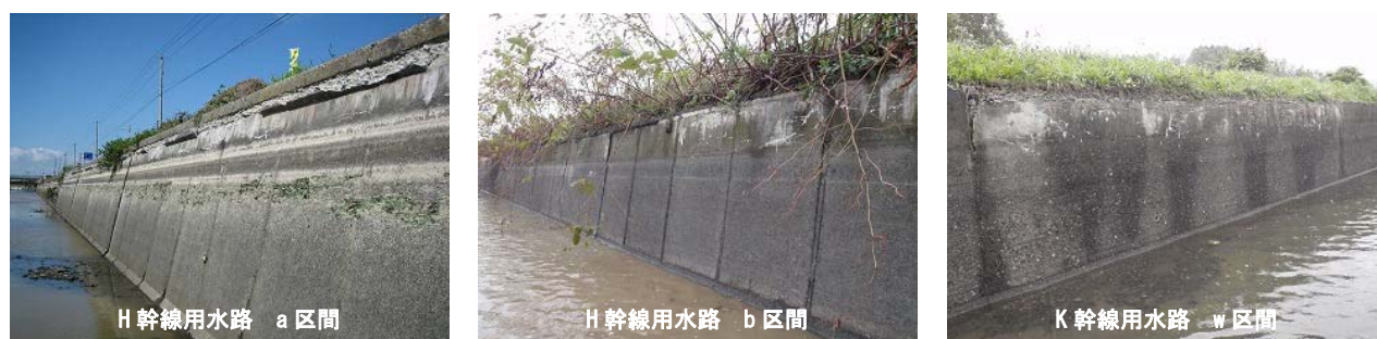
図-17 凍害劣化深さ推定対象の現況
