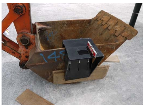
図-8 ソナー昇降装置取付金具のバックホウへの取付状況
