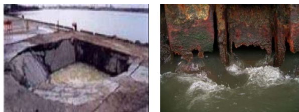
図-1 内部の空洞化により陥没した岸壁（左）と損傷した鋼矢板岸壁（右）
