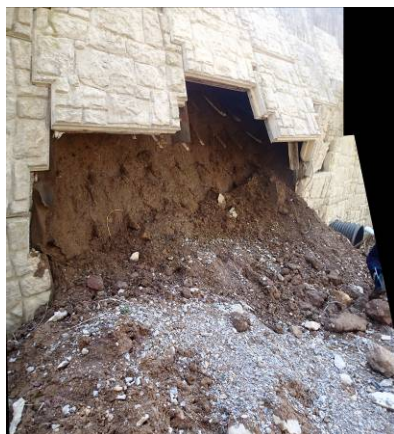
図-5.2 壁面パネルの脱落箇所の拡大（図-5.1 左下付近）
