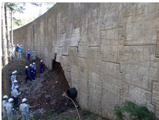
図-5.1 補強土壁の変状事例
