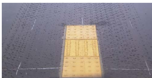
写真-8 細粒度舗装、障害者誘導ブロックの損傷
