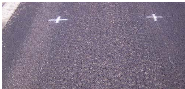
写真-5 排水性舗装の損傷
