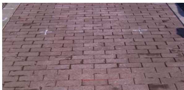
写真-7 インターロッキングブロック舗装の損傷
