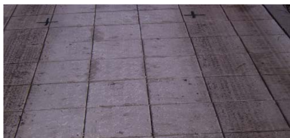
写真-6 平板ブロック舗装の損傷
