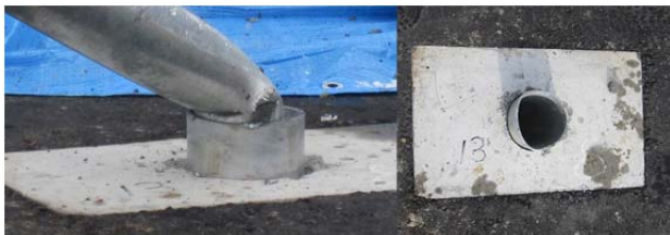
写真9 衝突の支柱及びスリーブ損傷状況 (5cm 突出)
