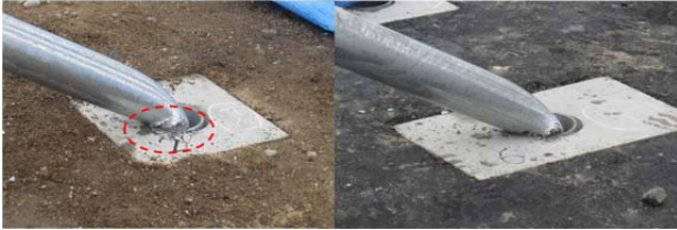
写真8 衝突の支柱及びスリーブ損傷状況 (左: 土中建て込み、右: 短尺スリーブ)
