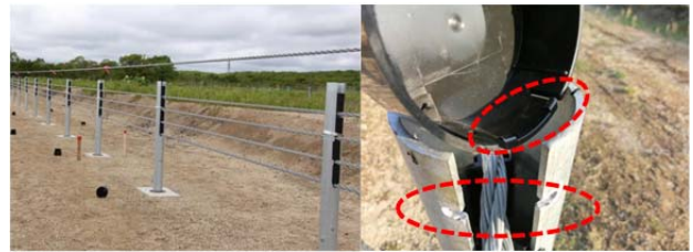
写真11 サグ区間のキャップ飛散状況と防止対策
