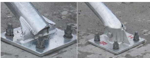
写真10 衝突後のベースプレートタイプの損傷状況 (左: 内リブタイプ、右: 外筒タイプ)
