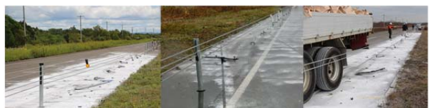
写真4 衝突後の防護柵破損状況 (左: 仕様1, 中: 仕様2・1回目, 右: 仕様2・1回目)
