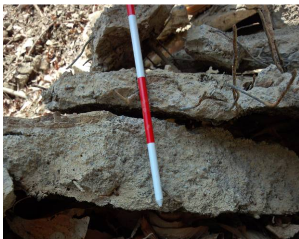
(e) 崩落したモルタルの断面
