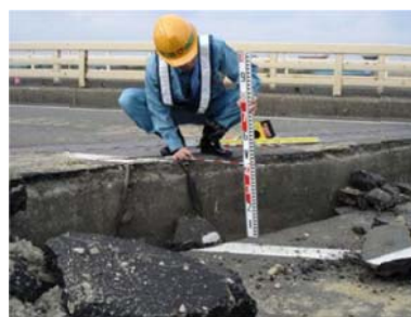
写真-1 橋台背面の段差 1)
