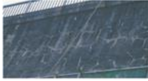
モルタル面のひび割れ
