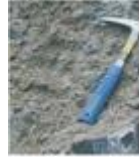
モルタルの土砂化
