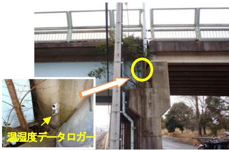
図-4.3 ジョイント漏水と樹木生育のある橋梁での観測
