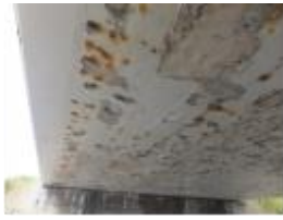
図-2.1 道路橋コンクリート床版の再劣化事例
