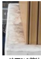
沈下ひび割れ
