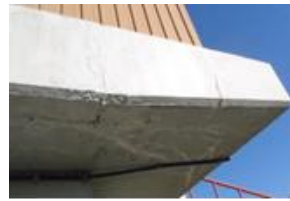
ひび割れとエフロレッセンス
