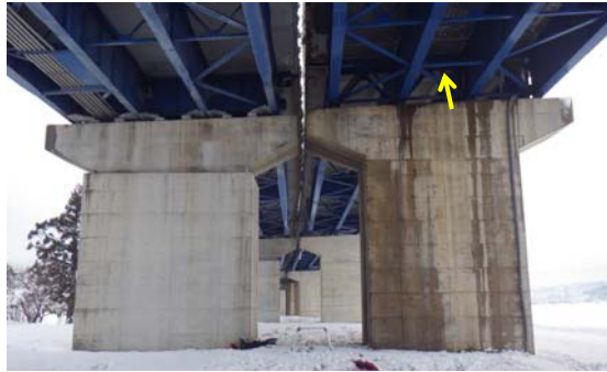
写真-1 多連連続桁橋の桁端部からの漏水事例 (奥に見える中間支点下の橋脚に比べて、橋脚の外観が漏水の有無により顕著に異なる。後述のC橋の外観)
