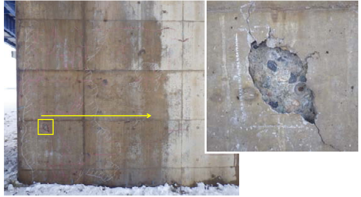
写真-3 C橋橋脚のひび割れと浮き、剥離 (写真-1の右橋脚の左下拡大、右上写真は実線四角部分の拡大、矢印は浮きのレーダ探査位置)
