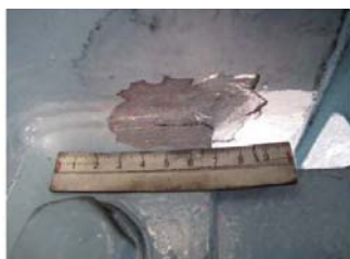
図-10 耳桁(端部の桁)垂直補剛材上端溶接部に発生した亀裂
