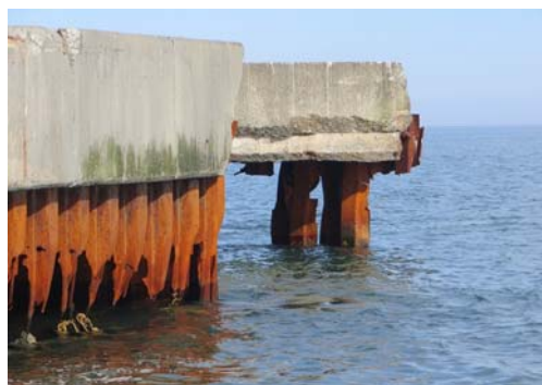
図-1(a) オホーツク海に面した導流堤の鋼矢板の損傷例
