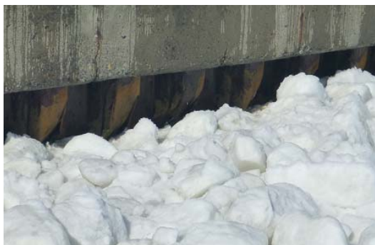
図-1 (b) オホーツク海に面した導流堤の鋼矢板の損傷例
